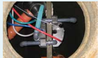
Vollbiologische Kleinkläranlage (SBR)
